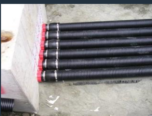
flexibles Leerrohr als Zuleitung
